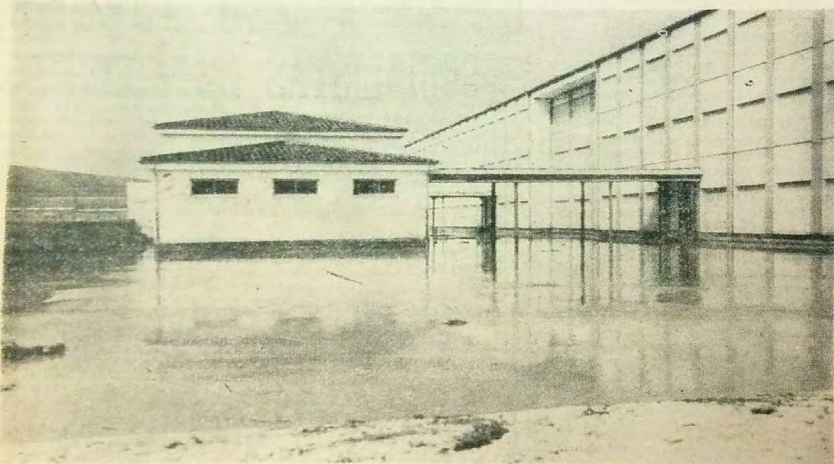
TORREDELCAMPO. — El patio del Instituto Nacional de Bachillerato es una piscina fangosa. Dentro del edificio también enró el agua
